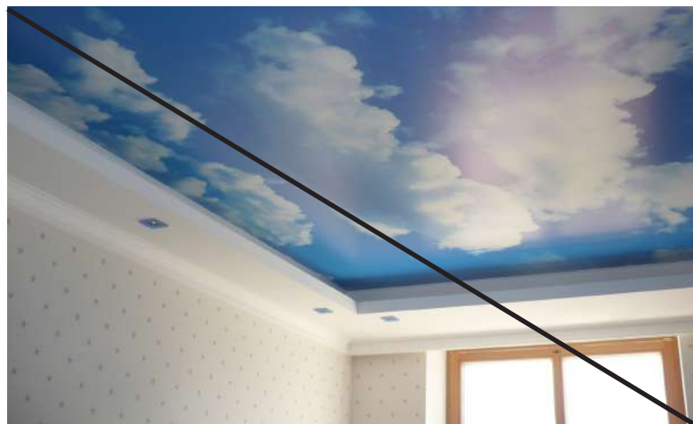
Плохо Натяжные потолки. Потолки с рисунками
